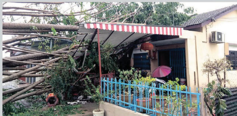
Keadaan kediaman Thong yang mengalami kerosakan akibat dihempap pokok tumbang.
